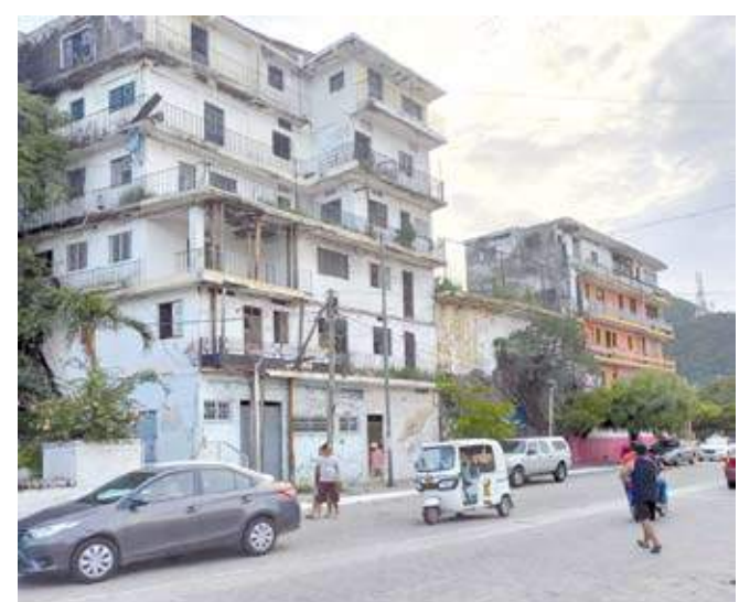
Por increíble que parezca este viejo edificio en ruinas no se derrumbó con el pasado sismo, algunos de los nuevos colapsaron.
